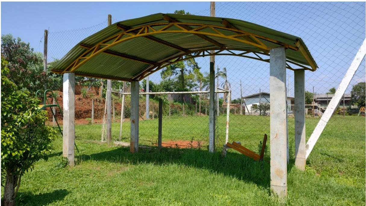
Figura 9: Cobertura em pré moldado.
