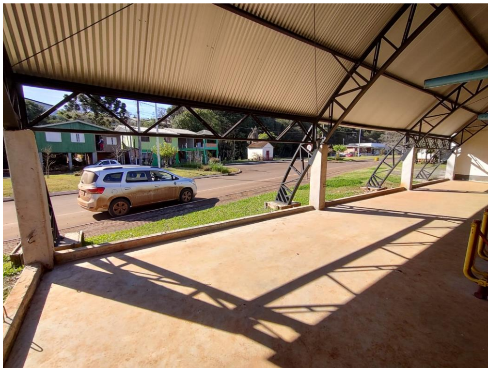
Imagens: Lado esquerdo à ser fechado com alvenaria.
